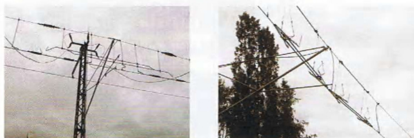
Bild 19: (links) Verkürzte Schutzstrecke. (unten El-Signale)
