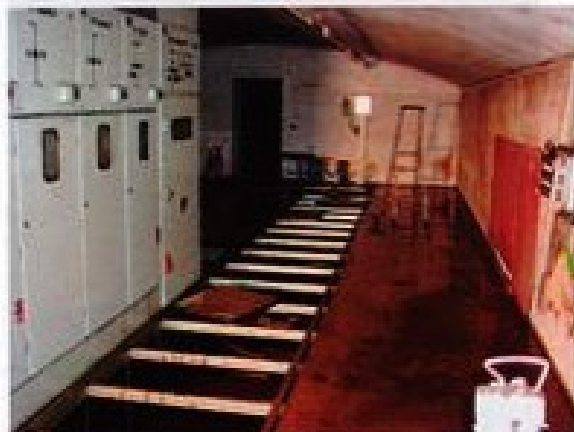
Bild 7: Transformatorstation Dresden Hauptbahnhof.
